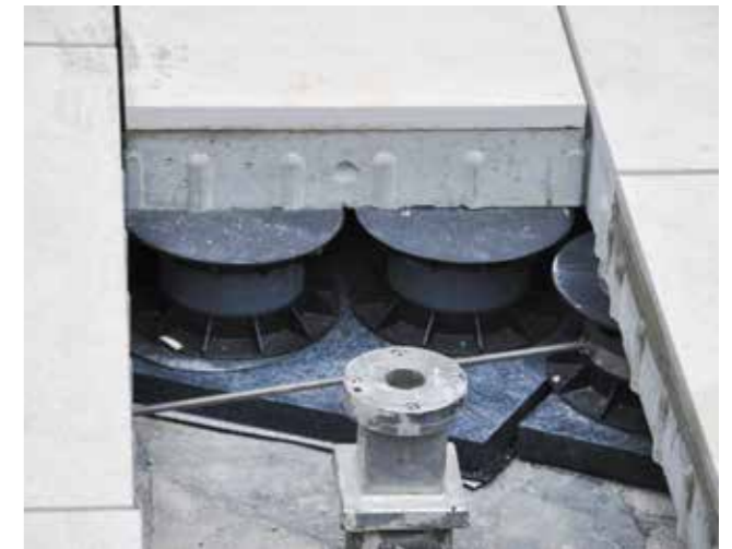
Système de support avec réglottes et tirants de fixation. Au premier plan, plot d'ancrage pour les pieds des nacelles de maintenance
