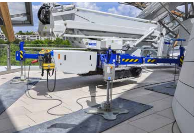
Lors de son fonctionnement, les pieds et patins de la nacelle sont posés sur des plaques de protection ou directement fixés aux plots d'ancrage
